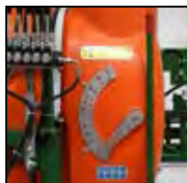
Indicador de nivel exterior Escalera de acceso al tanque principal.
